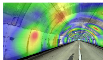
【判定の訓練】劣化進行度をヒートマップで確認
